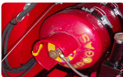
Impianto GPL LPG system instalación
